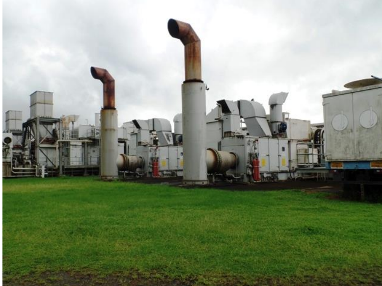
Central Térmica de Turbo Gas 28 MW de Capacidad Instalada (Antiguas Unidades)
