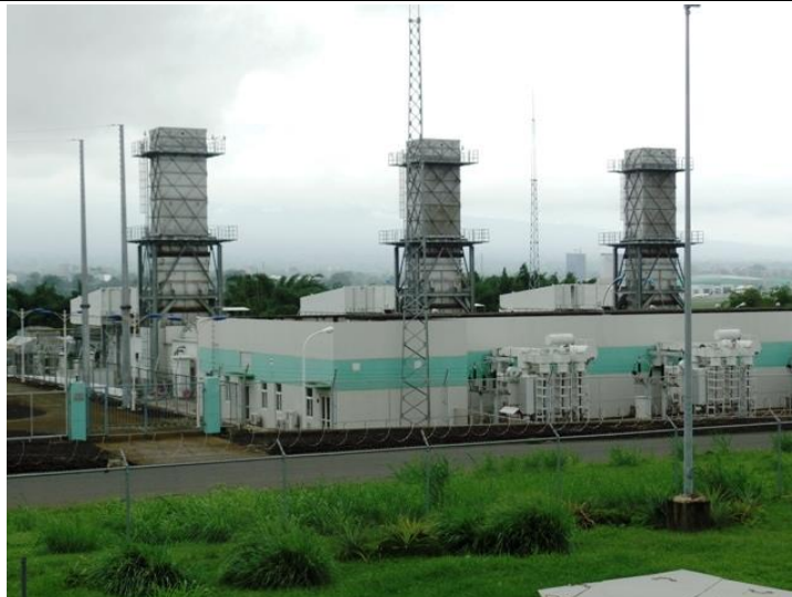
Central Térmica de Turbo Gas 126 MW de Capacidad Instalada (Expansión)
